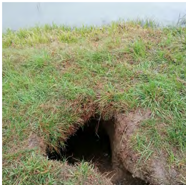
Slika 170. Udor na kroni nasipa oziroma brežine tik ob vodotoku.
