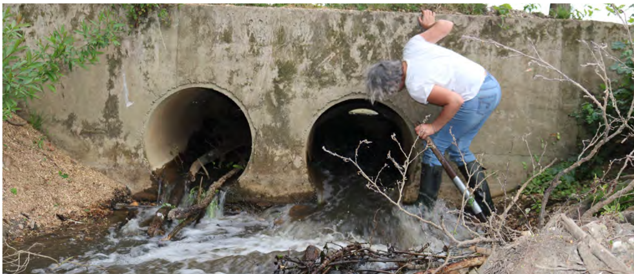
Slika 109. Zamašen cevni prepust.
