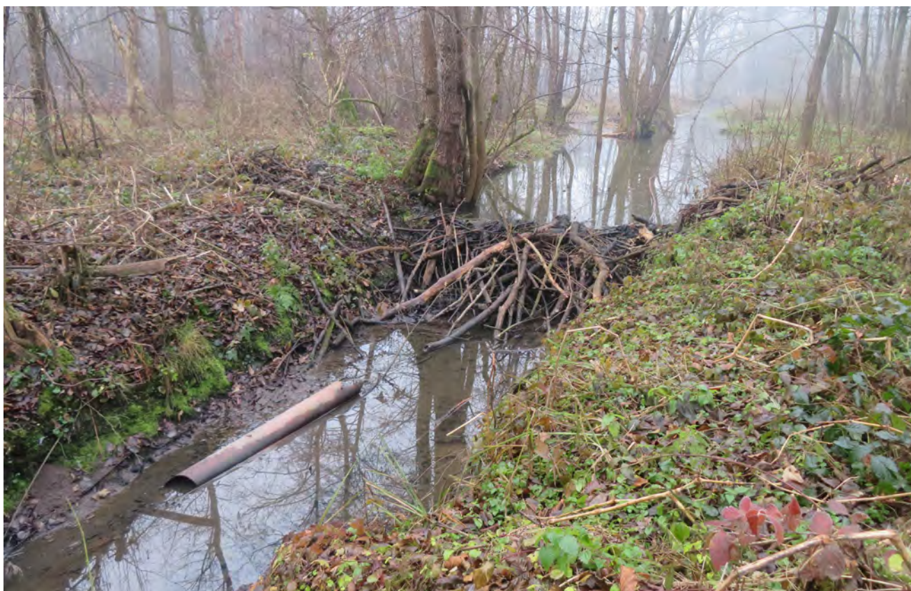
Slika 142. Odlomljen del cevi v strugi vodotoka.
