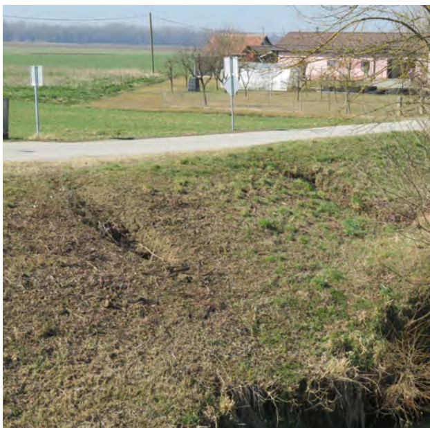
Slika 169. Udori brežine vodotoka ob cesti.
