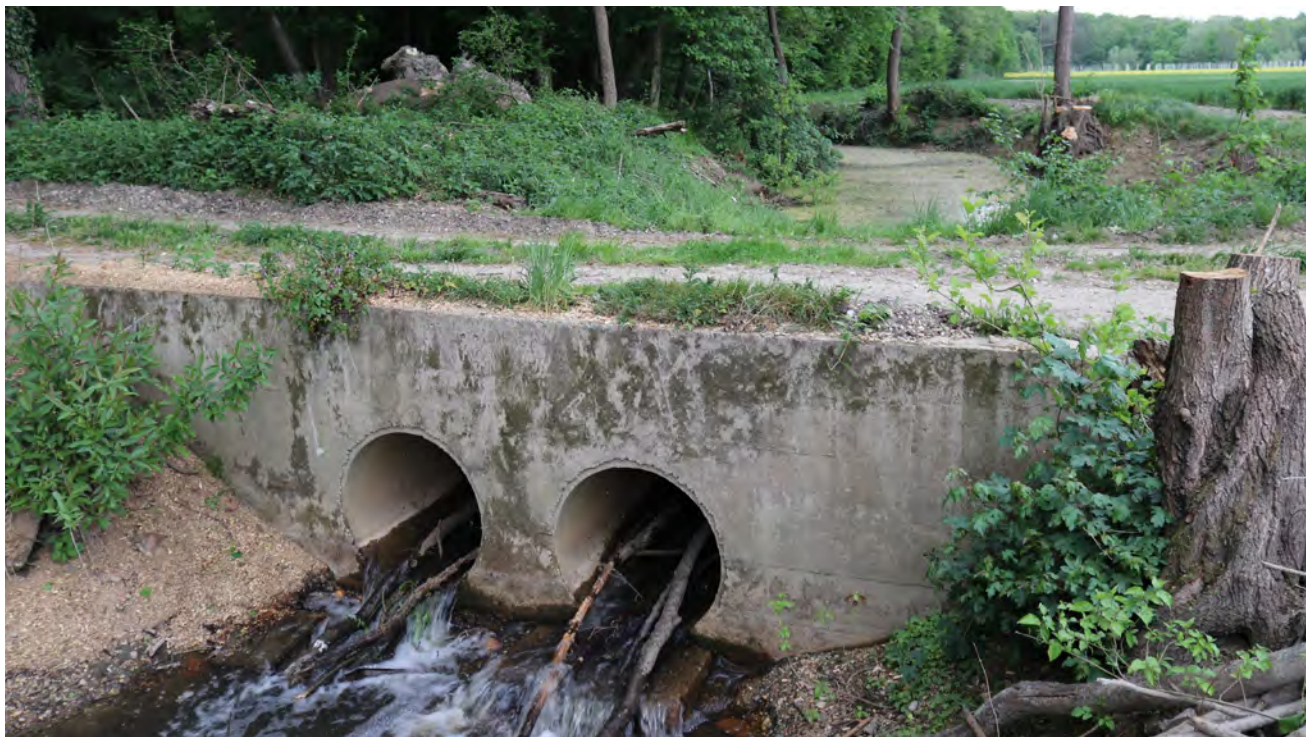
Slika 143. Zamašen cevni prepust.
