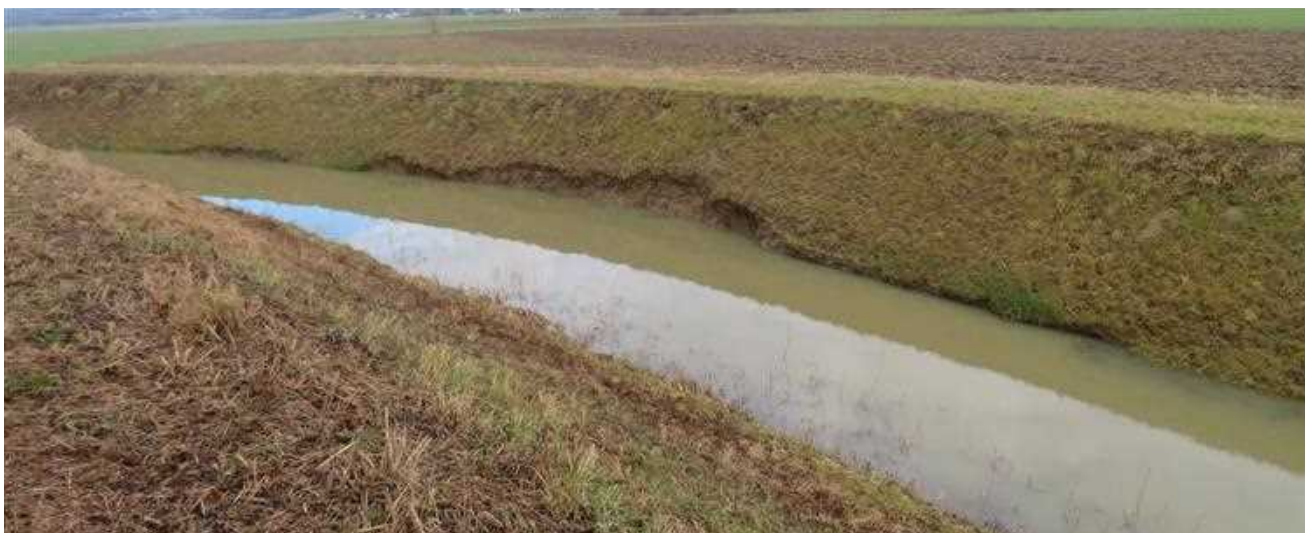
Slika 108. Zaradi omočenosti in višjega vodostaja lahko pride do erozije brežin.
