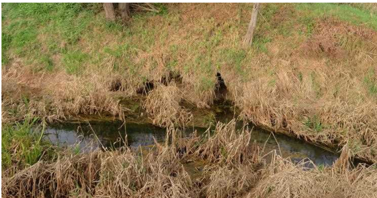
Slika 40. Izkopani brlogi v brežino vodotoka.
