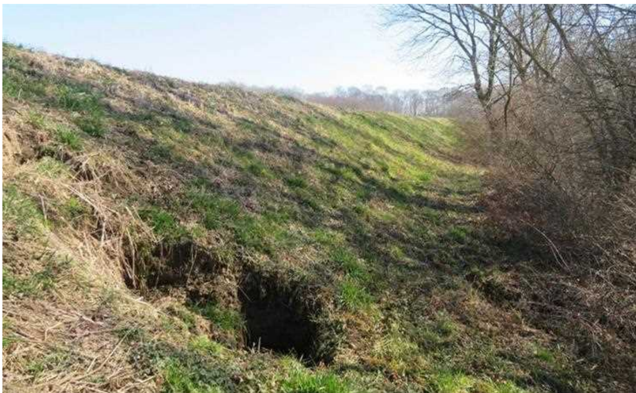
Slika 173. Poškodbe zaradi kopanja lahko nastanejo tudi na območju visokovodnih nasipov, če so ti v bližini vode.
