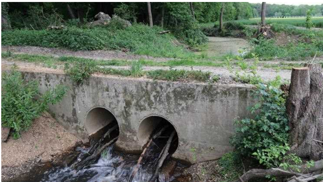
Slika 143. Zamašen cevni prepust.
