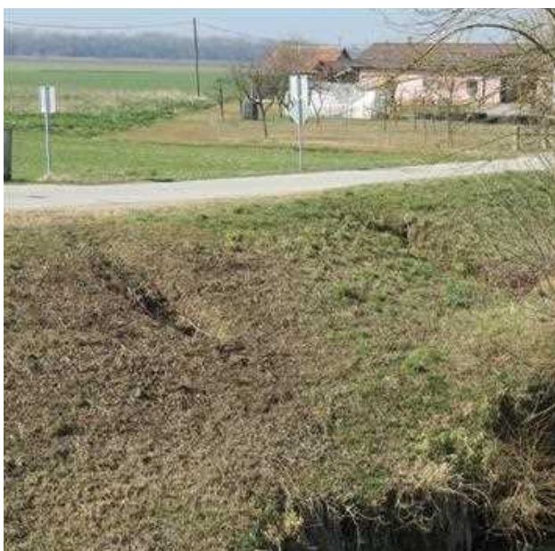
Slika 169. Udori brežine vodotoka ob cesti.
