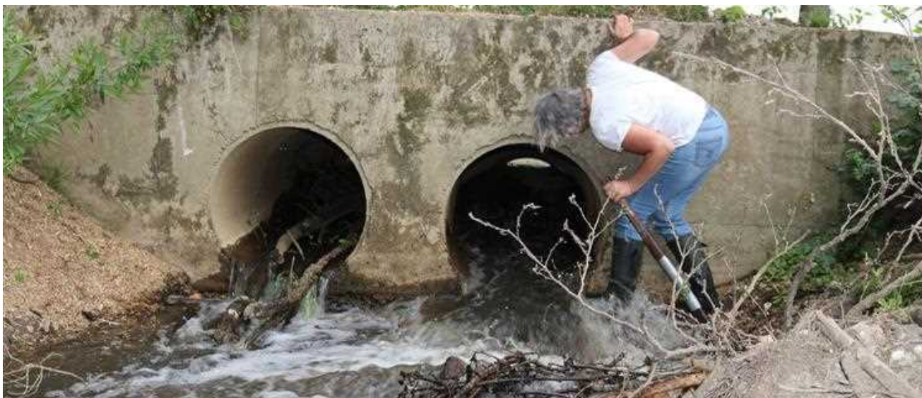
Slika 109. Zamašen cevni prepust.
